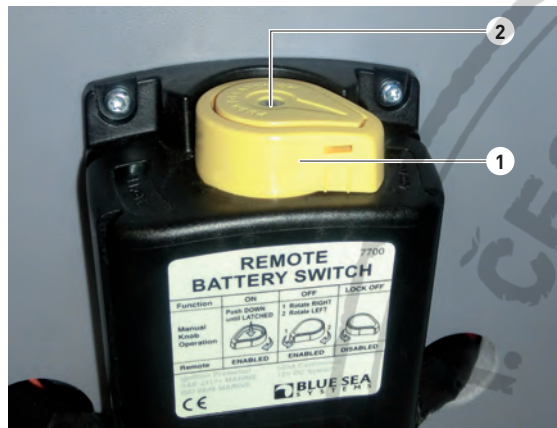
Abb. 13.11 Hauptschalter elektrisch und mechanisch AUS
