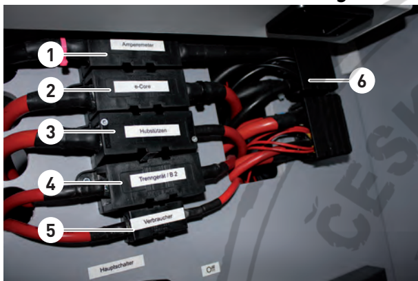
Abb. 13.15 Verteiler und Sicherungen
