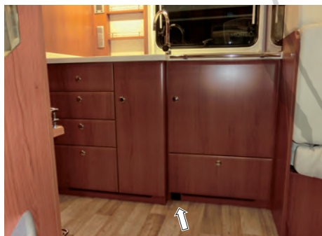
Abb. 12.8 Gas-Alarm-Bedienteil im Küchenbereich
